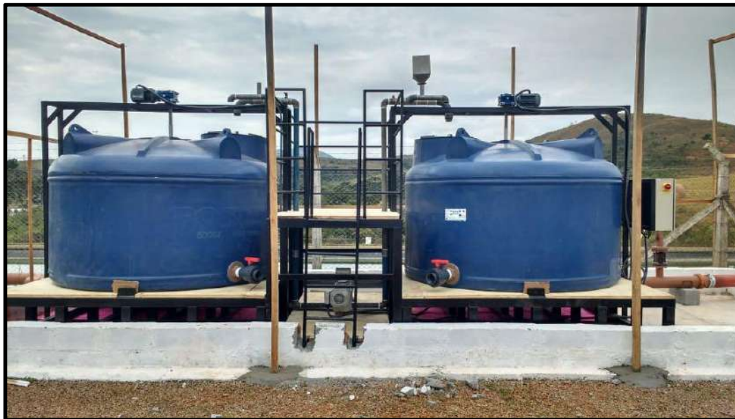
Figura 14. Sistema de preparo e dosagem de polímero.
