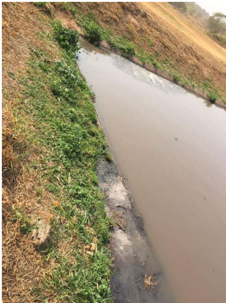
Foto 4: Borda da entrada da lagoa 3 encontra-se danificada.
