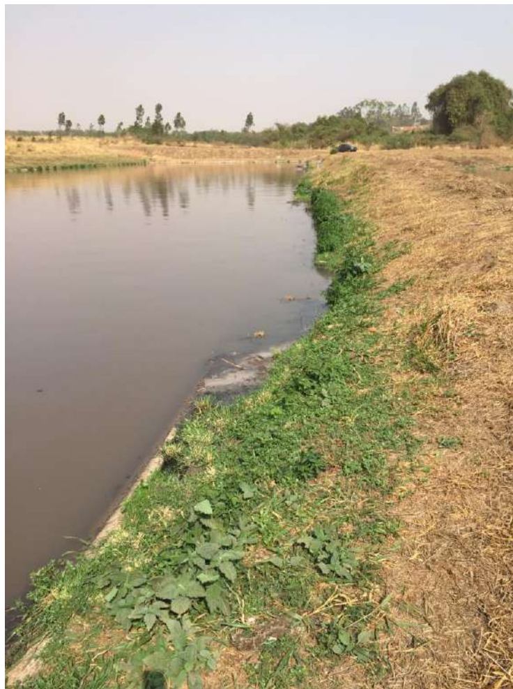
Foto 5: Borda da entrada da lagoa 3 encontra-se danificada.
